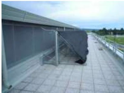
Pannelli solari termici
