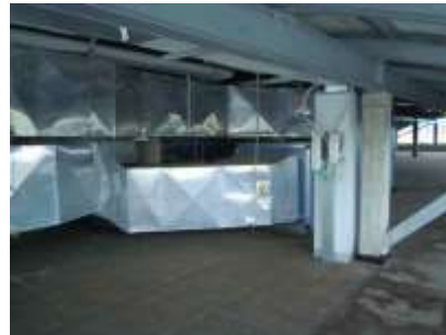
Impianto trattamento aria
